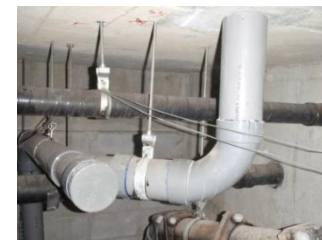
1階ピット下配管
